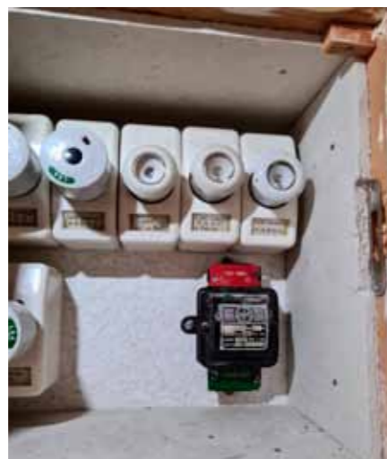
Ein alter Sicherungskasten: Hier ist mit grosser Wahrscheinlichkeit Asbest anzutreffen, der sauber entsorgt werden muss.
